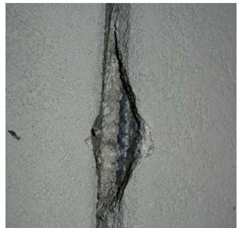
載荷後、天端欠け状況
