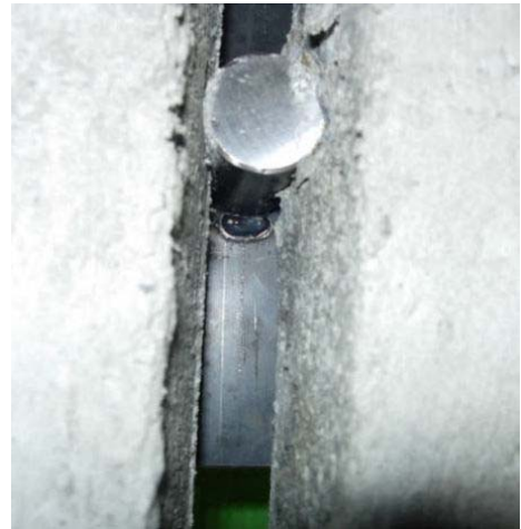
載荷後、スリット部欠け状況(内部)
