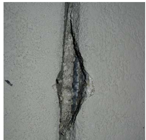
荷重後、天端欠け状況
