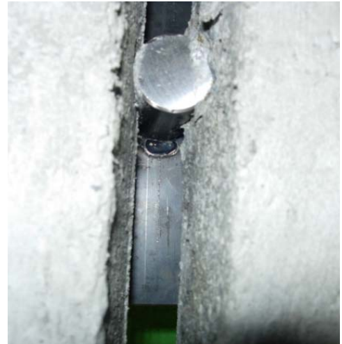
荷重後、スリット部欠け状況 (内部)
